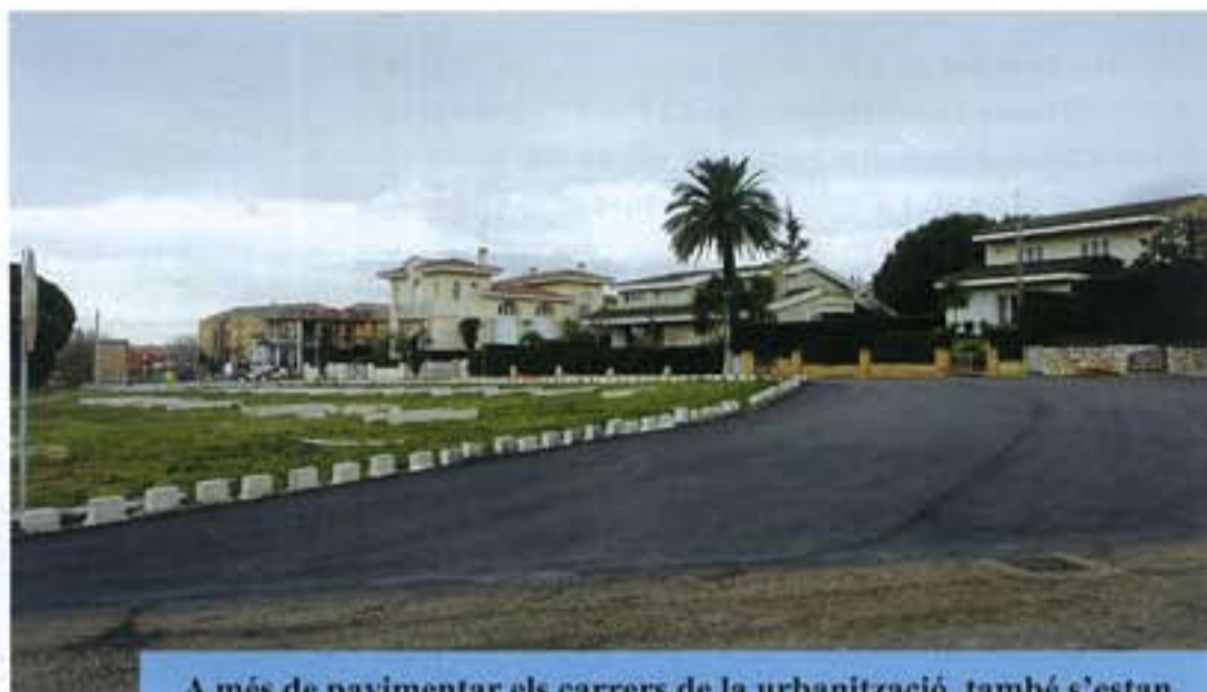
A més de pavimentar els carrers de la urbanització, també s'estan canviant els punts de l'enllumenat públic de la zona.
