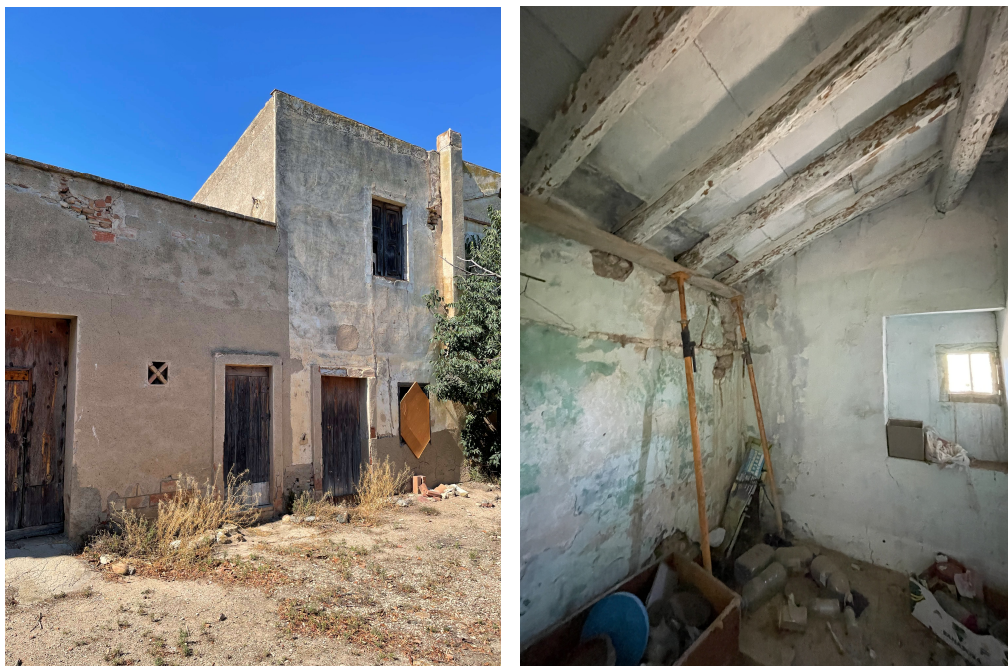
Estat actual de la façana sud i fotografia interior on es pot apreciar l'estat deteriorat de la coberta a restaurar.
