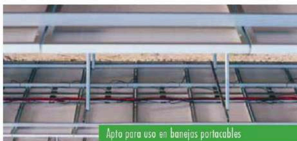
Conexión del panel al inversor
