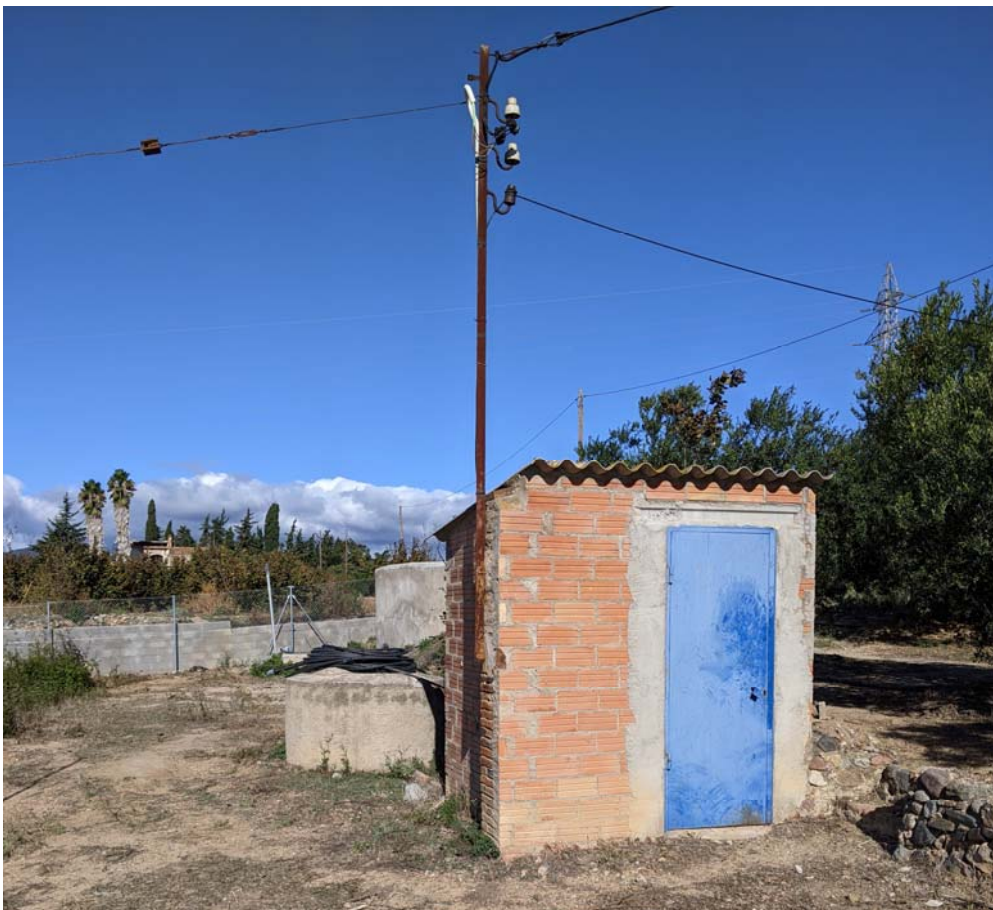
Caseta de la instal·lació elèctrica
