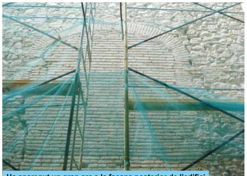
Ha aparegut un gran arc a la façana posterior de l'edifici
