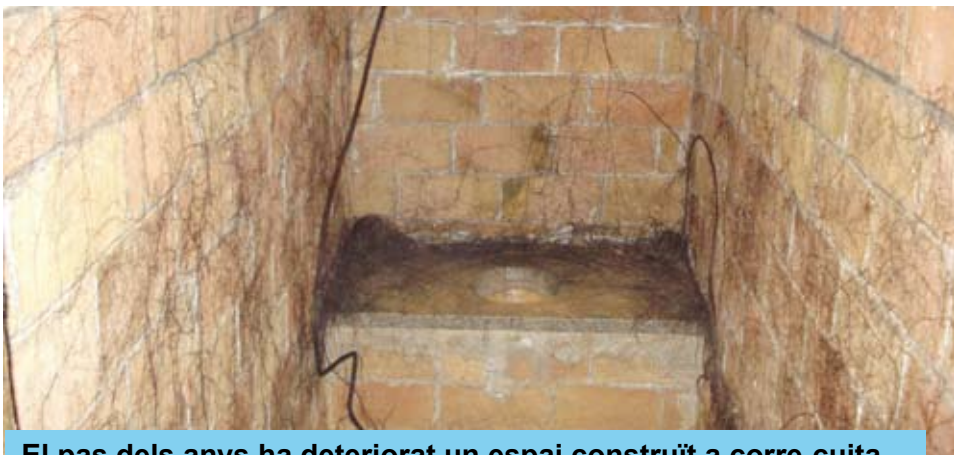
El pas dels anys ha deteriorat un espai construït a corre-cuita
